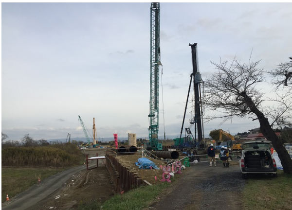
【荒川右岸（迫町佐沼）付近】 （仮）1号橋の橋脚基礎工事を行っています
