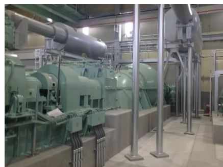
▲鶴家排水機場のポンプ
