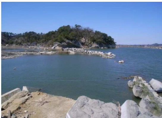
▲ 松ヶ島農地海岸堤防 被災状況
