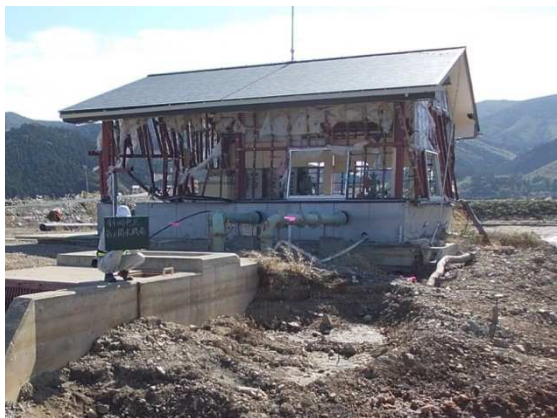
▲ 被災直後の針岡第一揚水機場
