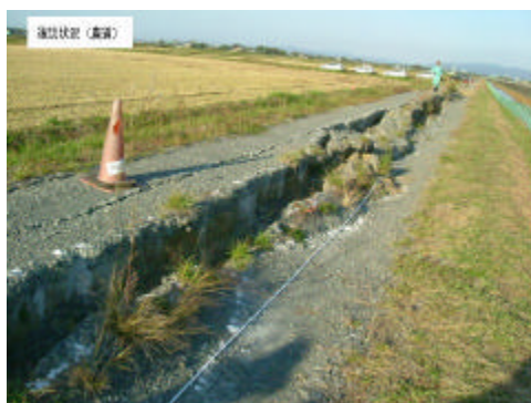
被害状況(農道)
