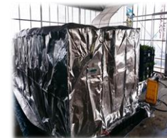
高濃度炭酸ガスくん蒸処理装置
