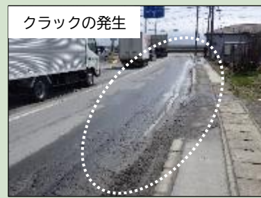
沿岸部の舗装劣化状況
