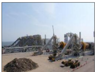
焼却炉稼働時の状況 (石巻ブロック)
