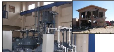
復旧した花笠第2排水機場 (山元町)
