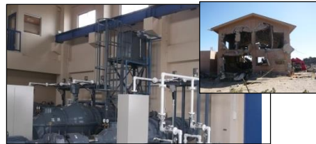
復旧した花笠第2排水機場 (山元町)
