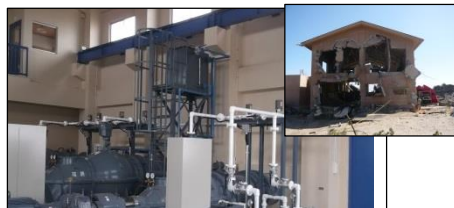
復旧した花笠第2排水機場 (山元町)
