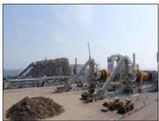
焼却炉稼働時の状況 (石巻ブロック)
