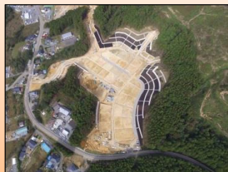
小淵浜地区 (石巻市)
