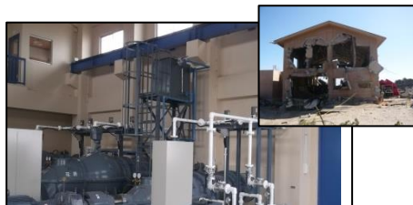
復旧した花笠第2排水機場 (山元町)
