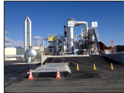
小泉地区焼却施設(気仙沼市)
