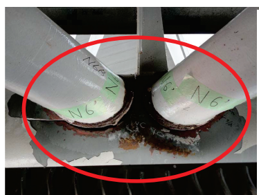
屋根 T 型梁の損傷状況
