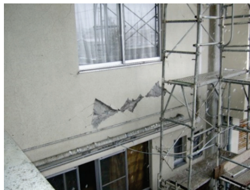
■写真 2-1-28：石巻合同庁舎の被災状況② 外壁剥落状況
