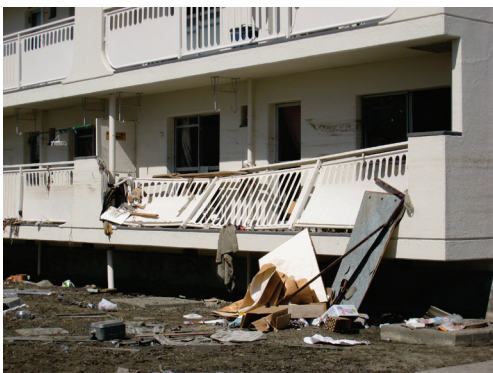
■ 写真 2-1-21：県営石巻鹿妻住宅の被災状況（石巻市鹿妻）
