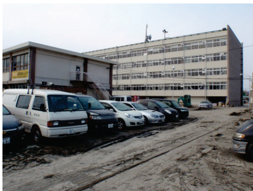
■写真 2-1-27：石巻合同庁舎の被災状況①外観全景 （保健所棟：RC2 階建て（手前），本館棟：RC5 階建て（奥））
