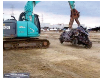
■写真 2-1-46：被災車両仮置状況
