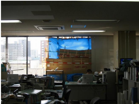
■写真 1-2-43：地震により庁舎のガラスが破損
