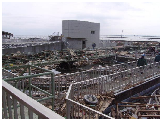
写真 1-2-38：東部浄化センター下水処理施設 (石巻市魚町)
