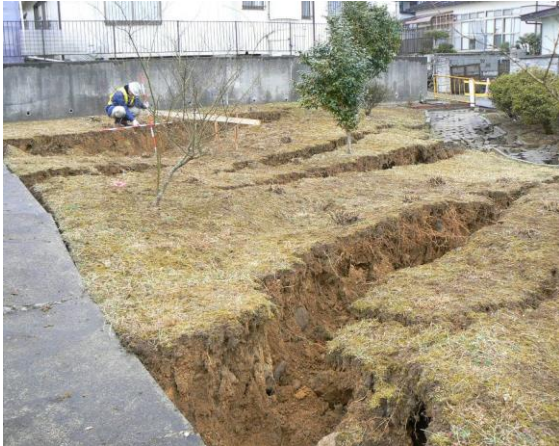
■写真 1-2-25 : 地すべり (仙台市太白区緑ヶ丘)
