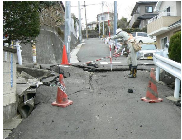
■写真 1-2-26 : 地すべり (仙台市太白区緑ヶ丘)
