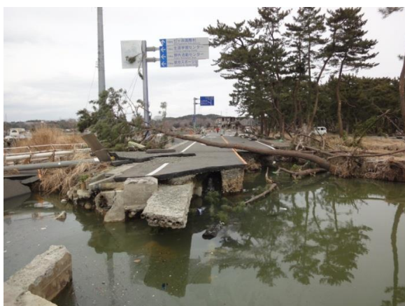
■写真 1-2-3：(主) 塩釜七ヶ浜多賀城線 (七ヶ浜町菖蒲田浜)
