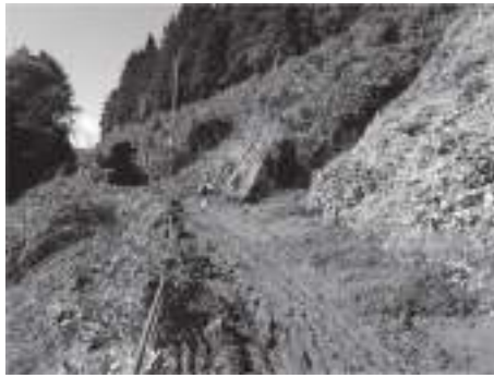
崩土による通行止め
