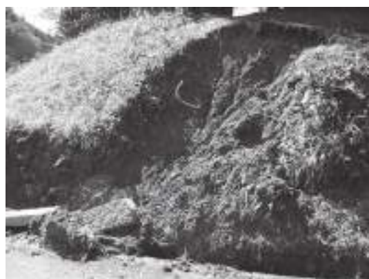
法面が崩壊した耕野小学校通学路
