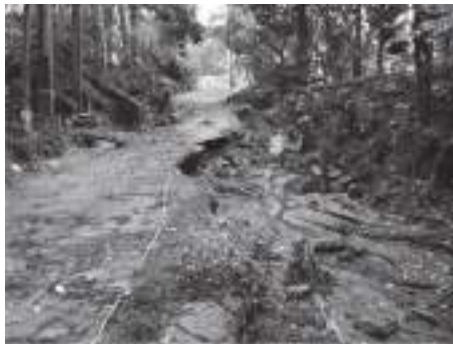
路肩崩壊による通行止め
