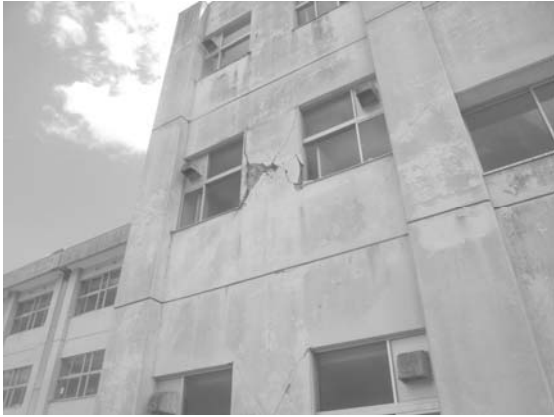
写真IX-3 被災状況（鉄筋コンクリート造柱のせん断破壊によるひび割れ・剥落）
