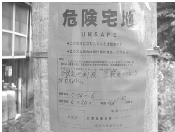
写真IX-8 判定の状況 （広範囲のひび割れ：「危険」の判定）
