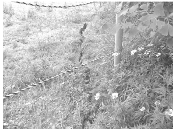
写真IX-7 被災状況（宅地のひび割れ）
