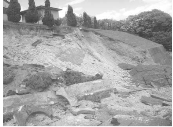
写真IX-4 被災状況（法面の滑落・崩壊）
