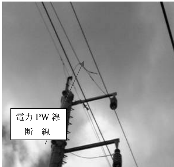
写真IX-1 1 東北新幹線 PW 線断線箇所
