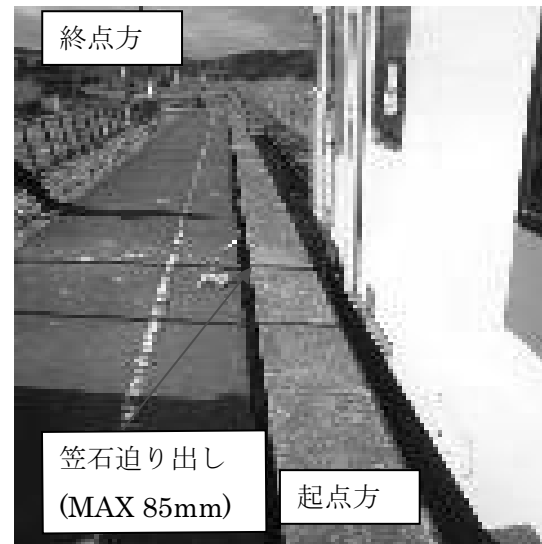
写真IX-1 2 陸羽東線 ホーム笠石迫出し箇所
