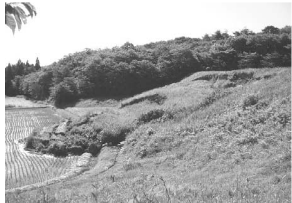
写真II-24 ため池の堤体被害 (栗原市旧栗駒町)
