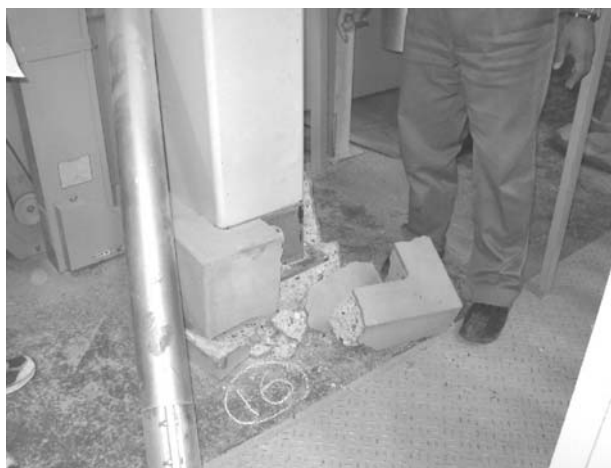
写真II-21 カントリーエレベーター柱の基礎部分の損壊 栗原市志波姫
