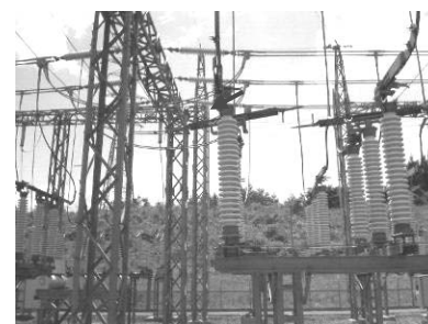
写真Ⅱ-3 大崎変電所断路器碍子傾斜状況
