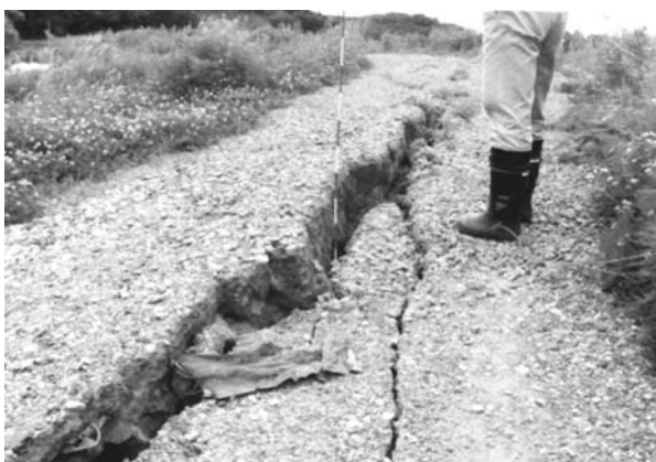
写真II-25 農道の亀裂被害 (栗原市旧栗駒町)
