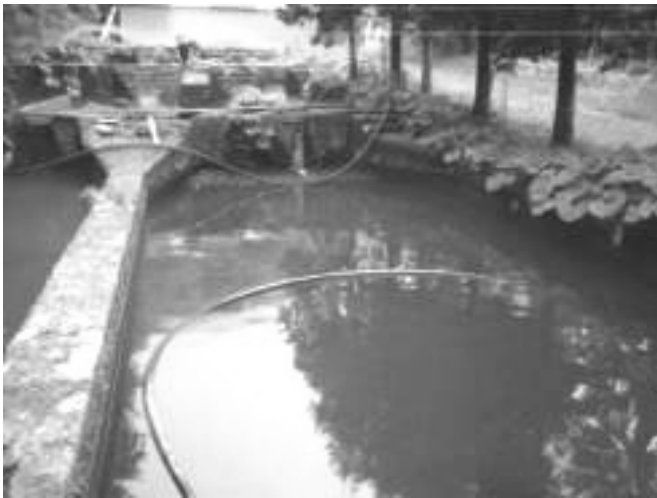
写真Ⅱ-28 破損により水位が下がり濁った養魚池（栗原市）
