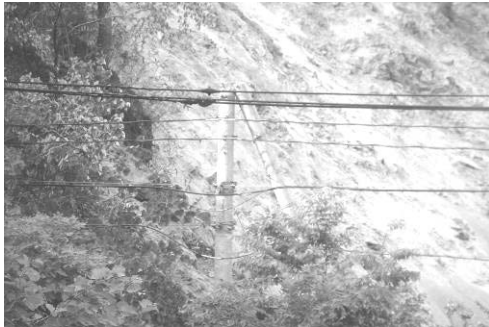
写真 II - 4 配電設備の被害状況写真①
