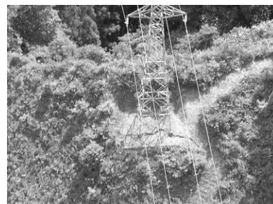
写真Ⅱ-2 6万6千ボルト送電線 鉄塔敷地クラック状況
