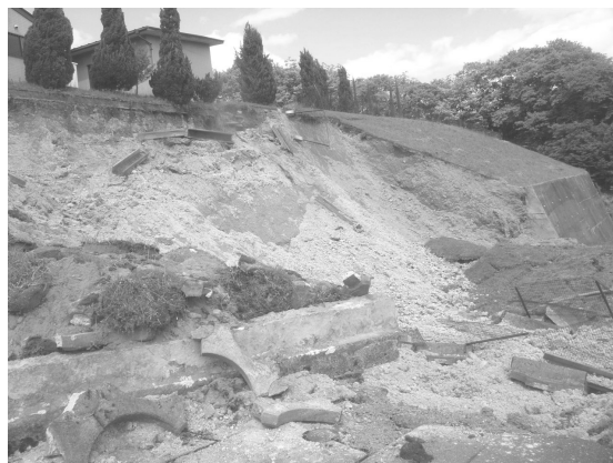
写真IX-4 被災状況（法面の滑落・崩壊）
