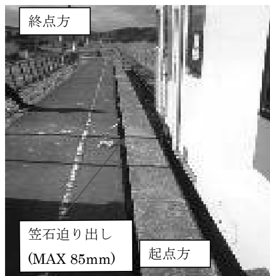
写真IX-12 陸羽東線 ホーム笠石迫出し箇所
