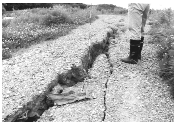
写真II-25 農道の亀裂被害 (栗原市旧栗駒町)
