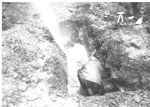
写真Ⅱ－7 栗原市文字簡易水道導水管の漏水
