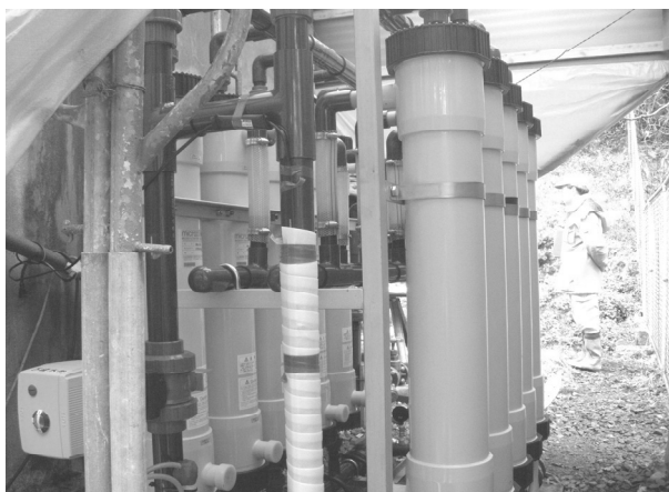
写真IX-9 大崎市鳴子上原簡易水道の膜ろ過施設
