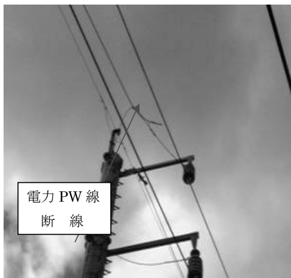
写真IX-11 東北新幹線PW線断線箇所
