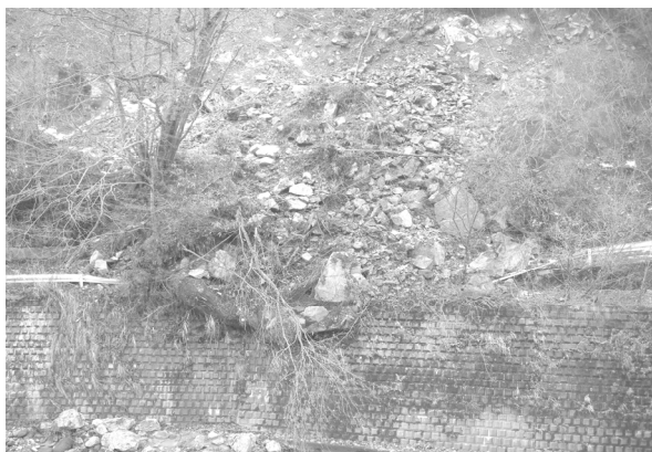
写真Ⅱ－6 栗原市浅布・小川原飲料水供給施設取水源の崩壊
