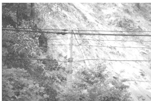
写真 II - 4 配電設備の被害状況写真①
