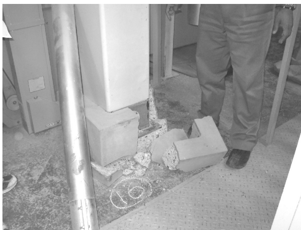
写真Ⅱ-21 カントリーエレベーター柱の基礎部分の損壊 栗原市志波姫
