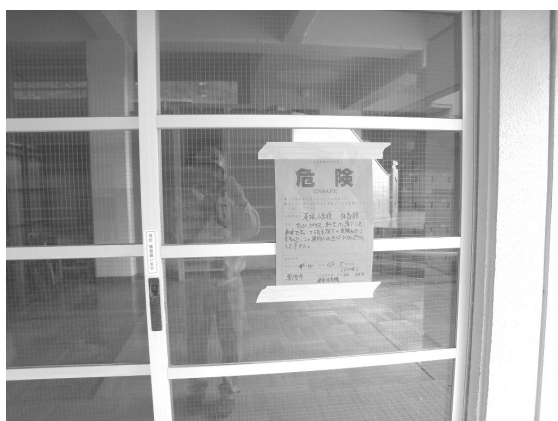
写真IX-5 判定士の状況 （サッシ、ガラス等の落下：「危険」の判定）
