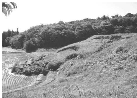
写真II-24 ため池の堤体被害 (栗原市旧栗駒町)
