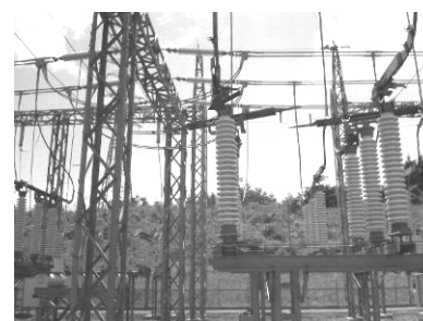
写真Ⅱ-3 大崎変電所断路器碍子傾斜状況
