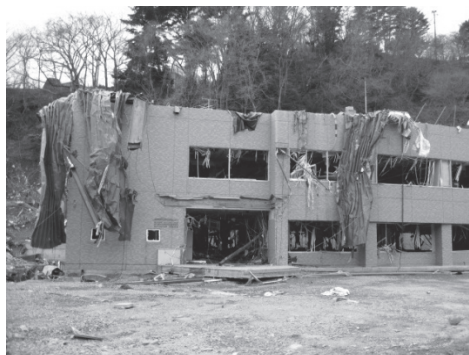
被災した原子力防災対策センター
