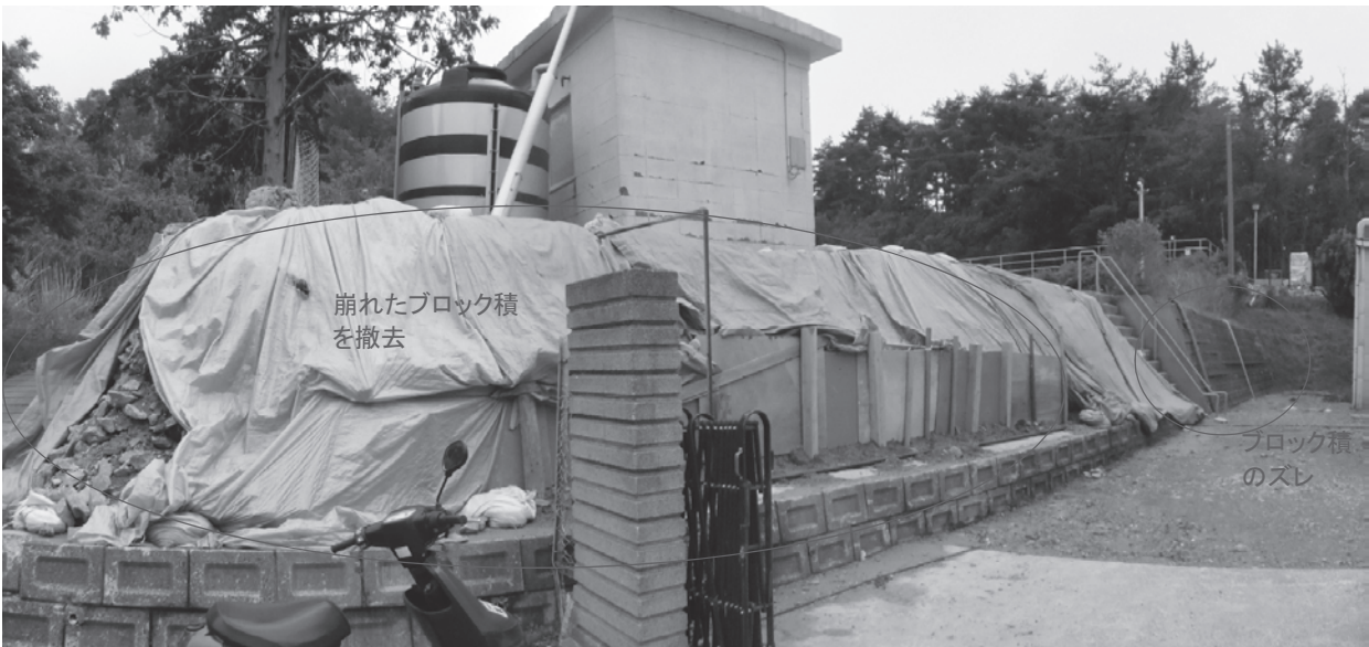
沈殿池及び薬注室敷地のブロック積擁壁の崩壊
