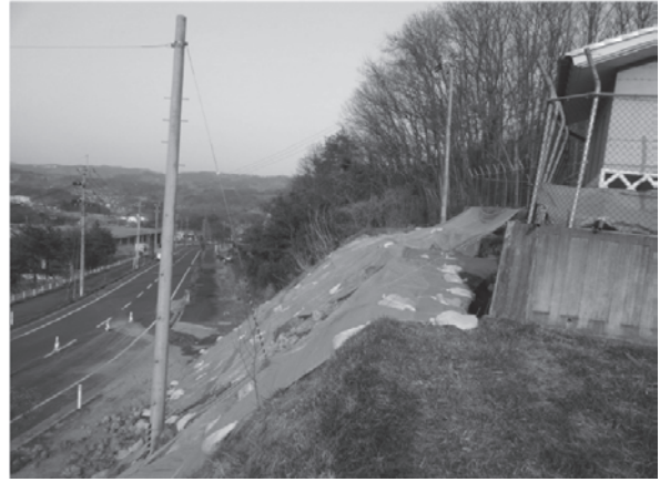
西原ポンプ室の被災状況 (敷地法面崩壊による上屋の傾斜)
