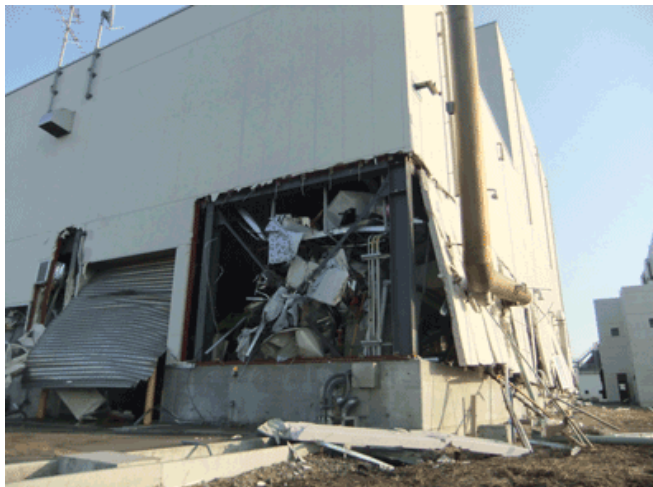
汚泥処理施設被災状況
