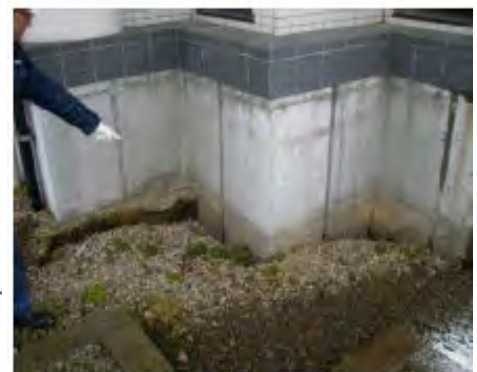
地震直後の場内陥没状況
