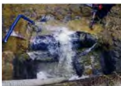
志波姫ポンプ場前圧送管 漏水状況
