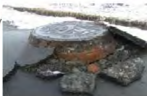
マンホール隆起(富谷幹線、外多数)
