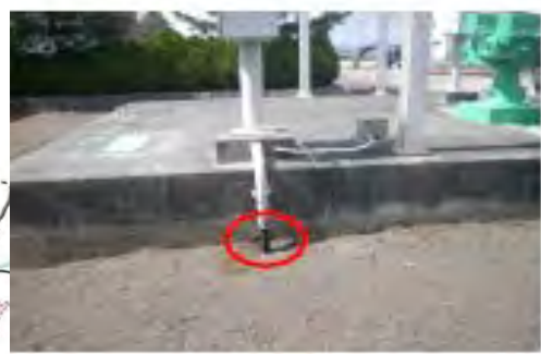
流入ゲート電気配管損傷
