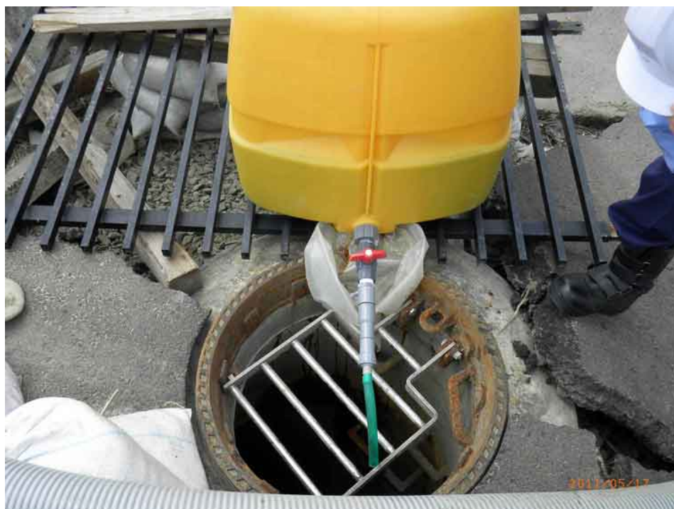
写真 2-1-2 県南浄化センター 塩素消毒状況
