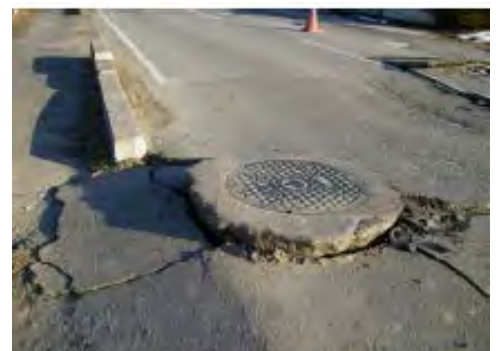
志田幹線マンホール隆起状況
