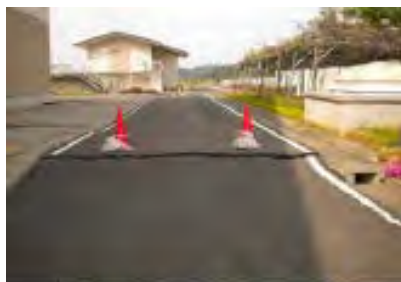
石越浄化センター場内舗装 段差発生
