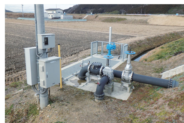
引浪沢排水機場
