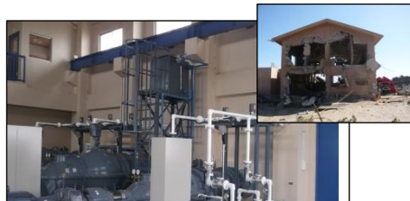
復旧した花笠第2排水機場 (山元町)
