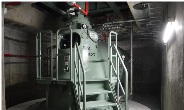
ポンプ2号機本体
