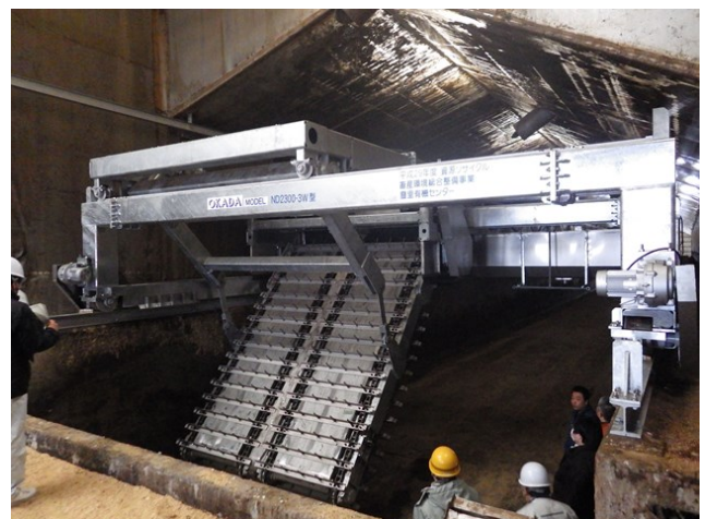
新しく導入した攪拌機
