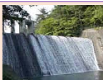
青下第1・2・3ダム 管理者：仙台市水道局 所在地：仙台市青葉区 >仙台市水道局HPへのリンク
