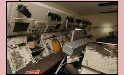
▲被災直後の管制塔一階 レーダー室
