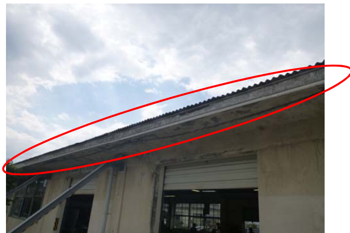
庇部分の防水モルタルの防水性能がなくなっており、庇に雨が浸みて、先端のモルタルが劣化し、落下する危険性があります。庇上には、草が繁茂しています。
