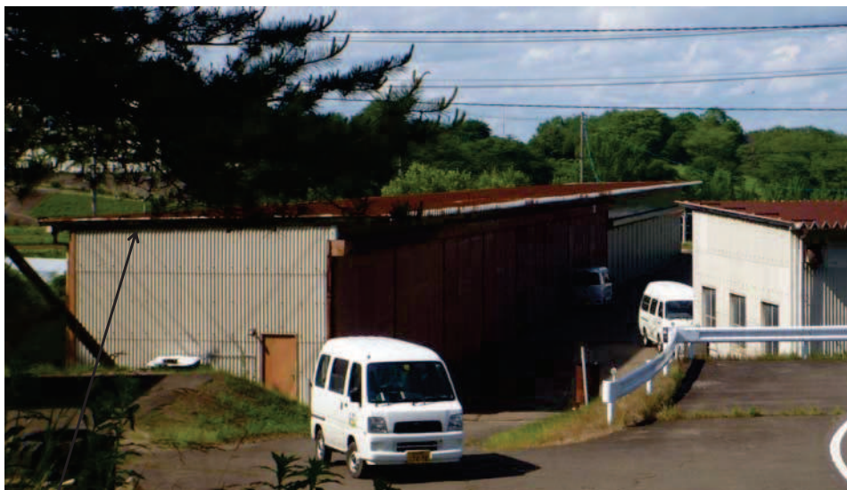
屋根面がサビて著しく劣化していることが確認でき ます。
