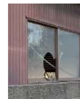
窓が割れた管理不全空家
