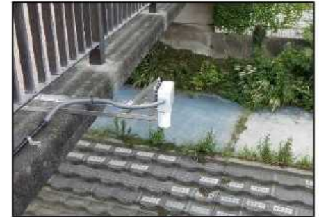
水位計の整備、改良
