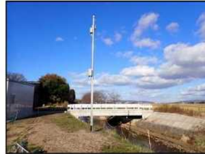
河川監視カメラの整備、改良
