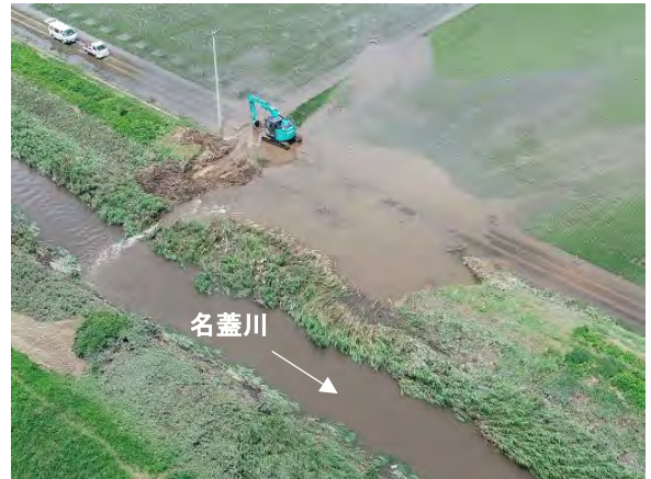
名蓋川の堤防決壊状況 (大崎市)
