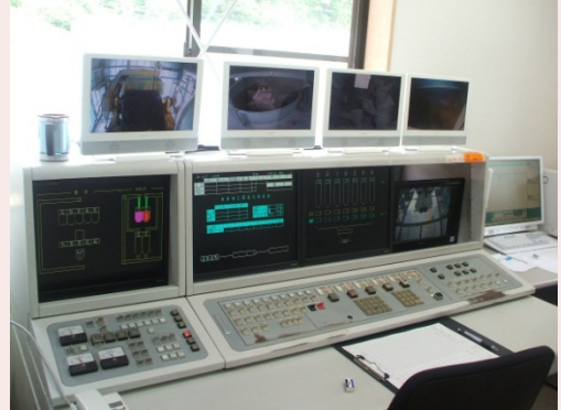
操作室(操作盤)近景
