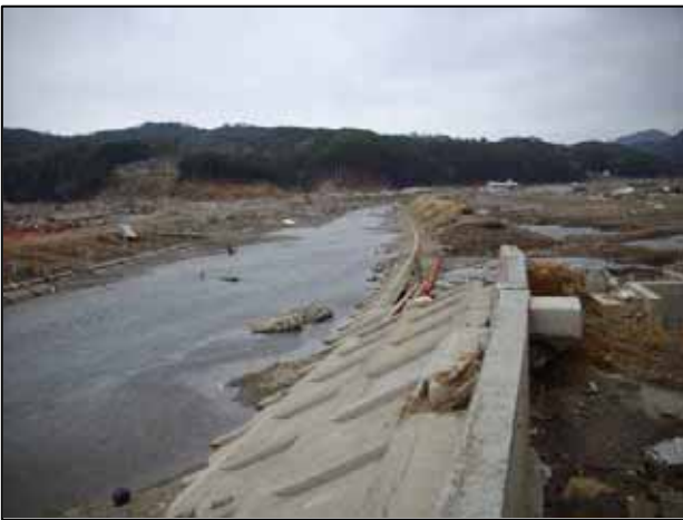
①左岸堤防 破堤
