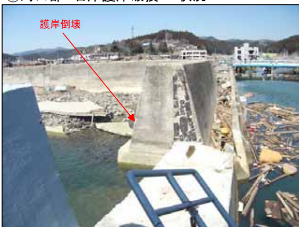
③河口部 右岸護岸破損 状況
