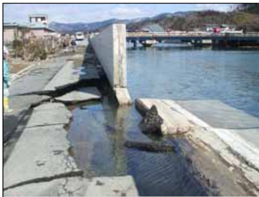
③右岸 護岸倒壊
