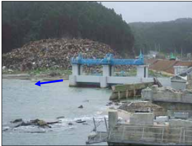
②右岸側破堤
