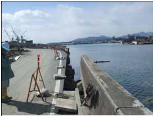
②河口部左岸 護岸倒壊
