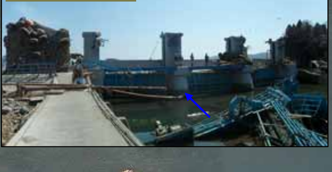
水尻川防潮水門全損
