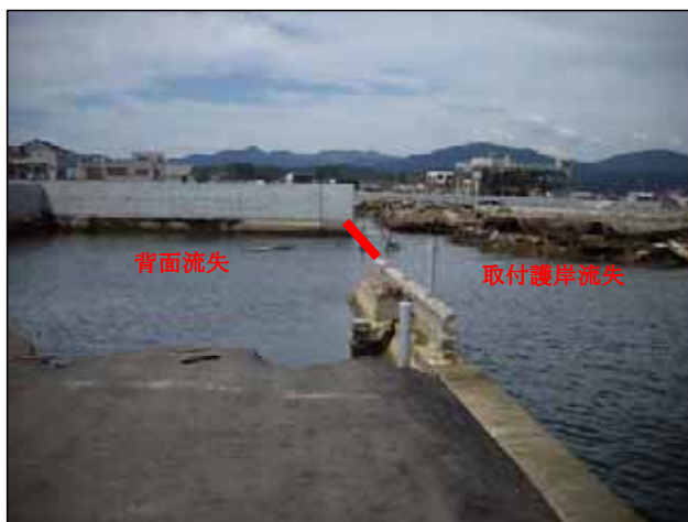
・-4.5m岸壁 取付護岸流失
