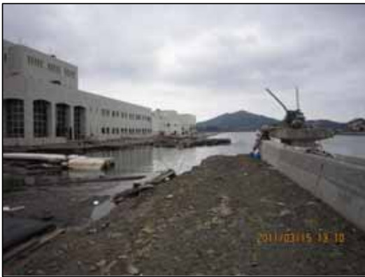
①左岸(市下水処理場裏) 護岸倒壊
