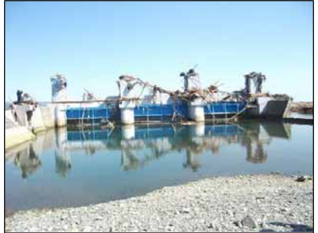
①水戸辺川防潮水門 全損
