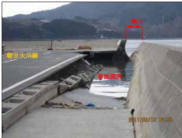
・護岸転倒による背面流失
