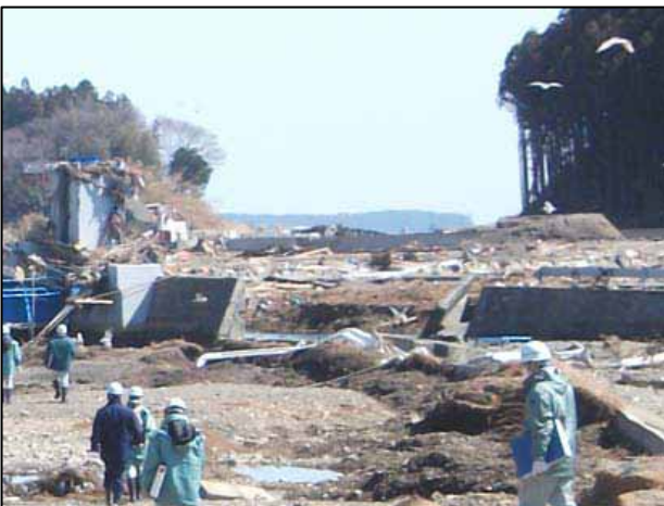
③河口部右岸 破堤
