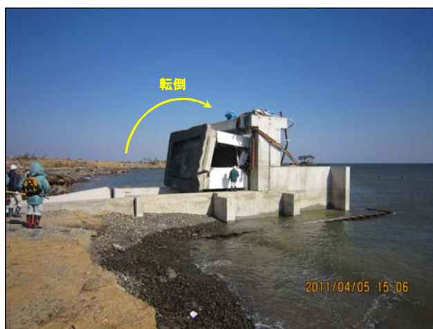
②防潮水門操作室建屋転倒
