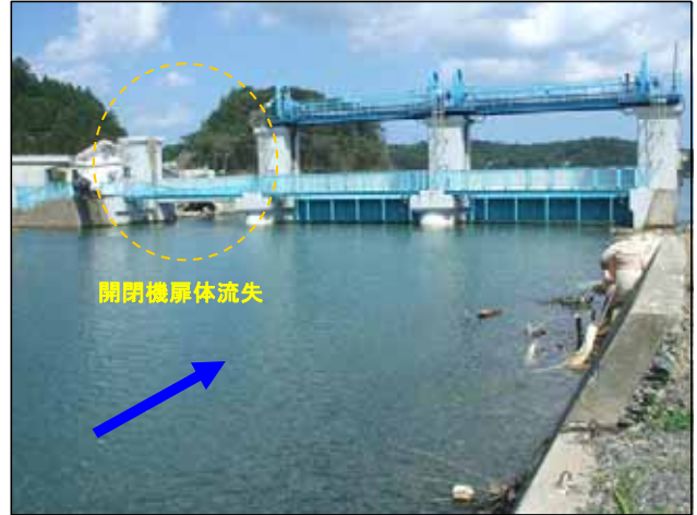
①伊里前川防潮水門開閉機扉体損傷
