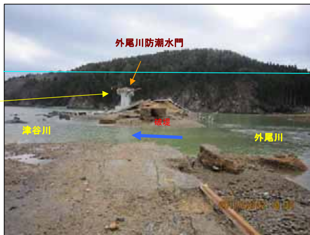
①外尾川左岸破壊
