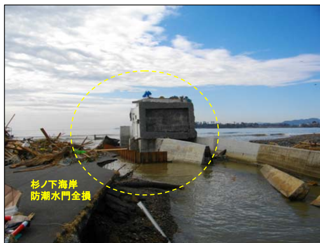
①防潮水門全損
