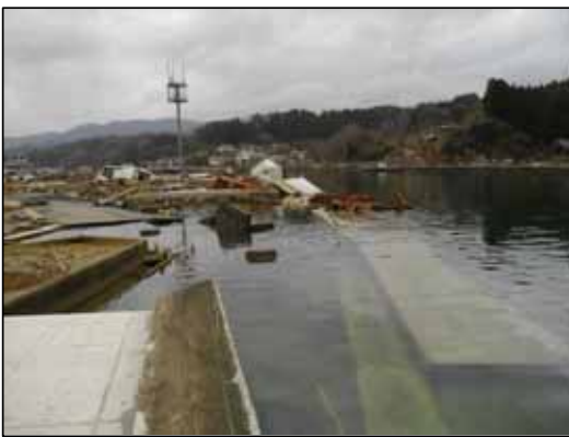
①河口部右岸 護岸倒壊
