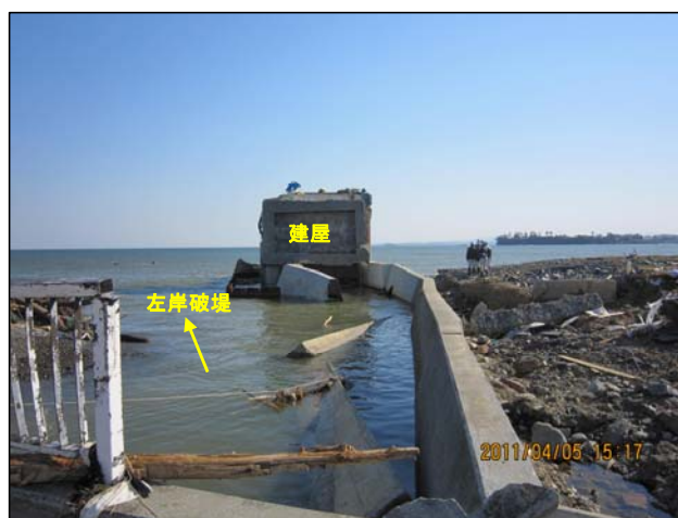
③防潮水門左岸破堤
