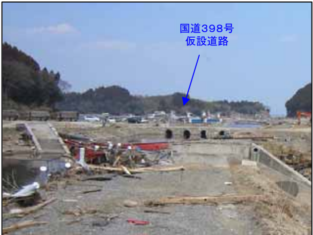
②国道398号 横津橋落橋(仮設道路設置)／3月
