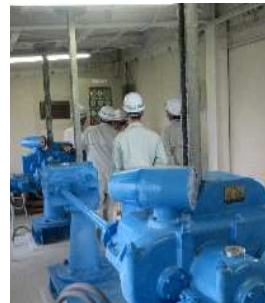
【杉ヶ崎樋門の 操作手順の確認状況】
