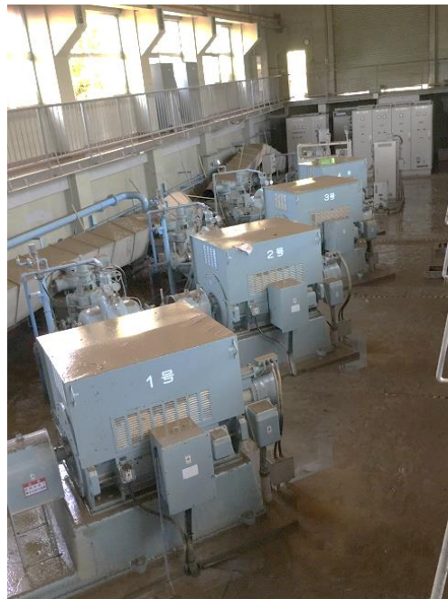
取水ポンプ機能停止
