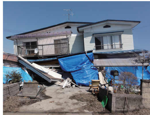
建築物の被災状況(仙台市)
