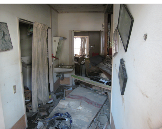
石巻吉野住宅被災状況
