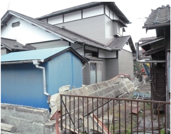
ブロック塀の倒壊
