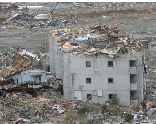
志津川廻館前住宅被災状況
