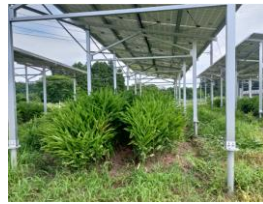
【営農型太陽光発電施設】
