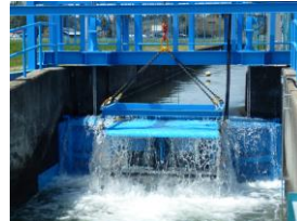
【小水力発電施設】
