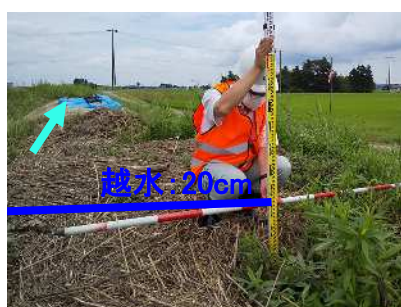
越水写真(痕跡)
