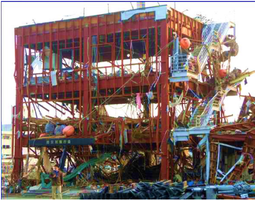
南三陸町防災対策庁舎
