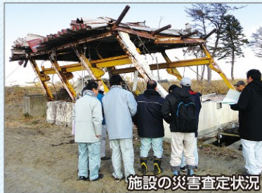
施設の災害査定状況
