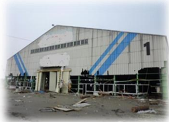
被災した木材加工施設
