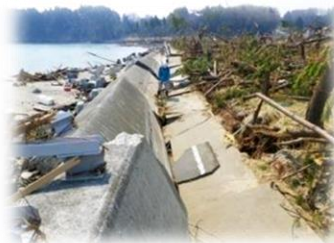
被災した防潮堤と海岸林
