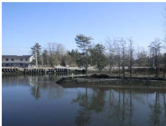
写真 1.5 貞山運河 [御舟入堀(砂押貞山運河)]の被災状況 左: 橋本橋付近 右: 県仙塩浄化センター付近 下: 旧砂押川と砂押貞山運河合流点の石積護岸
