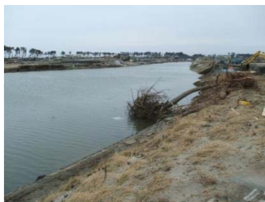
写真 1.3 新堀の被災状況
