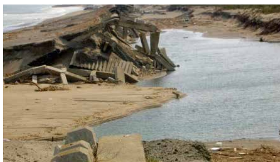
相ノ釜・納屋地区海岸の被災状況（岩沼市）
