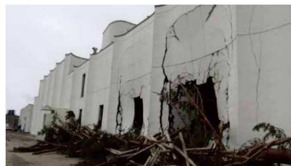
南蒲生浄化センターの被災状況
