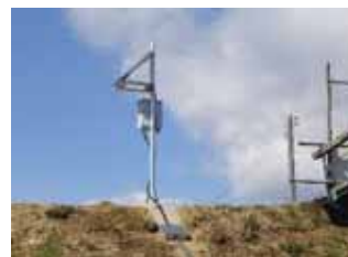
危機管理型水位計 (新川・村田町)
