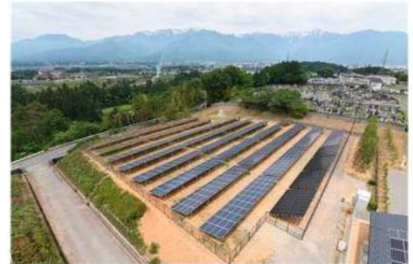
リユース品を使用した発電所の例
