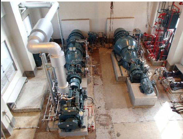
▲南田排水機場機械設備完成写真(R4.3)
