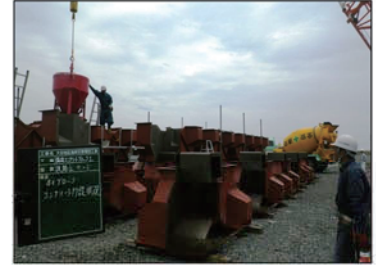
大谷地区海岸災害復旧工事 「消波ブロックコンクリート打設状況」
